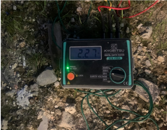
Gambar 2. Hasil Pengukuran Grounding
